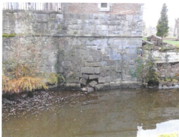
1 december, plaatselijke instorting
